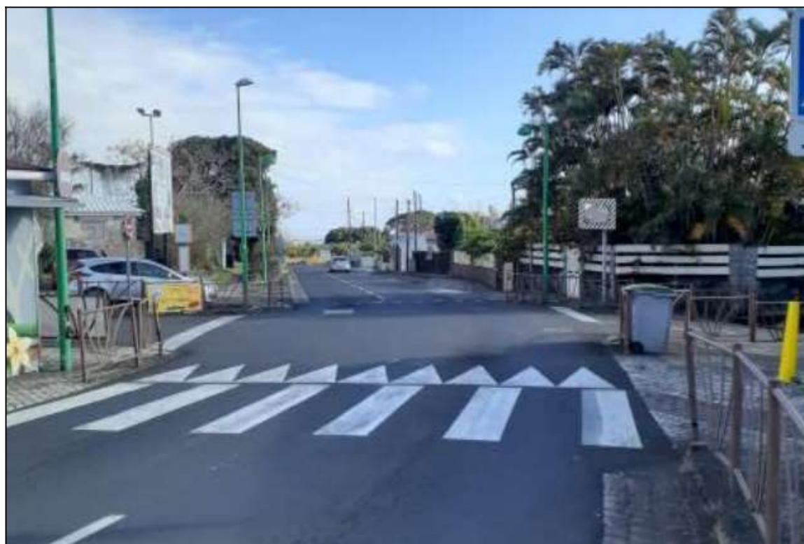
Illustration 4: limitation de vitesse à 30km/h, création d'un plateau traversant et suppression des pavés à Petit Saint-Pierre RN2
