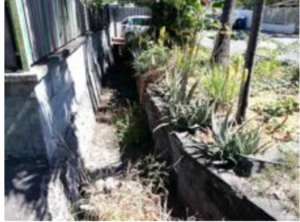
Figure 16 : canalisation en aval de la zone de rétention
