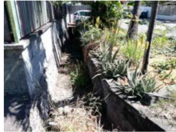
Figure 5 : canalisation en aval de la zone de rétention
