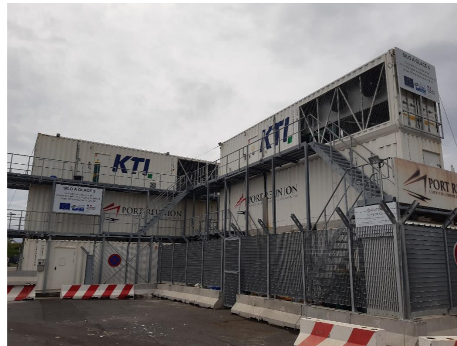
Nouveaux silos à glace n°4 et 5
