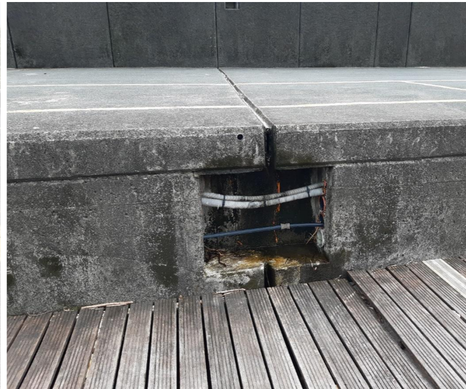
Installations actuelles obsolètes sur les réseaux eaux et électricité
