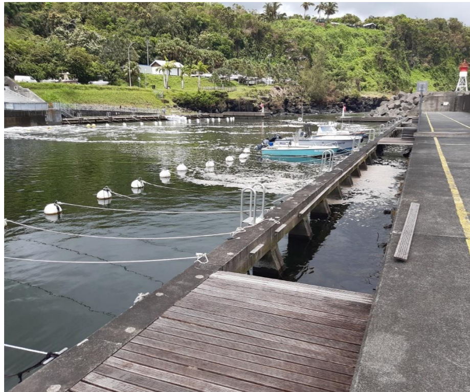
Dégâts causés par le cyclone Belal
