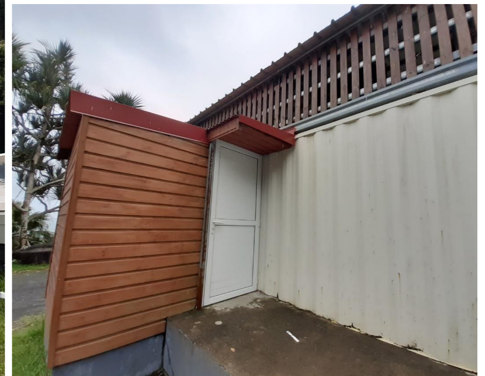
Machine à glace et chambre froide (d.) avec sas d'entrée (g.)
