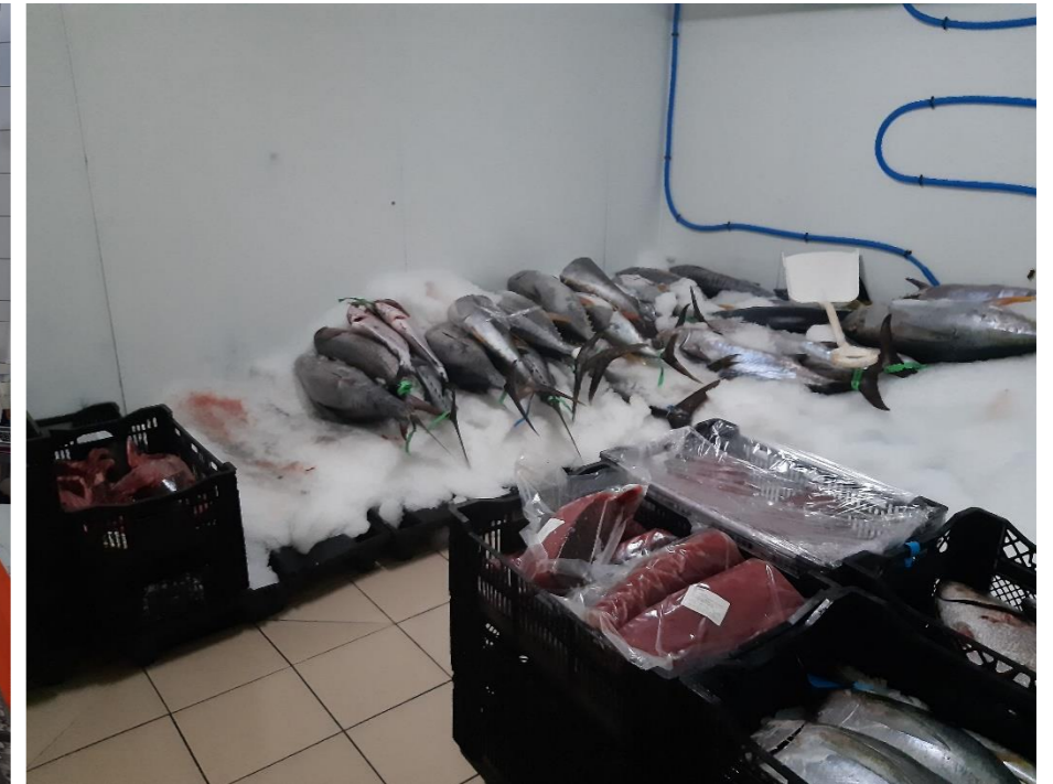
Chambre froide de stockage
