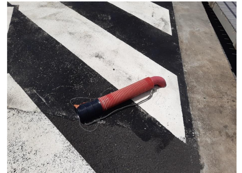
Arrivée électrique pour la potence
